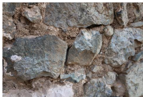
貧弱なアース・モルタル
