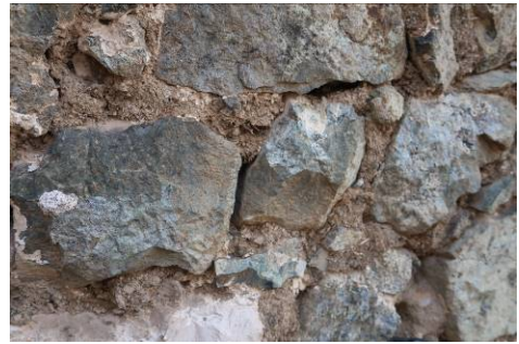
貧弱なアース・モルタル
