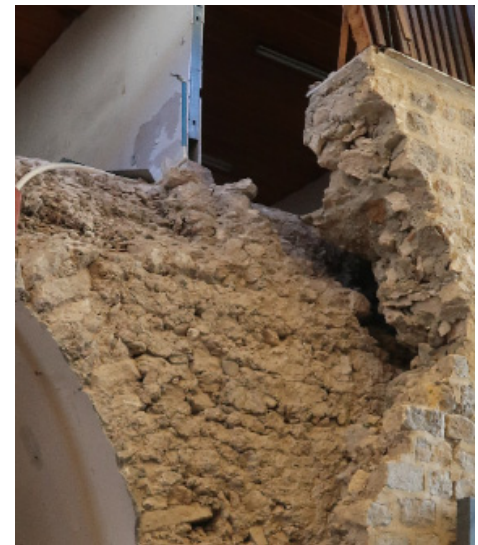
玉石組積造壁体の破壊状態
